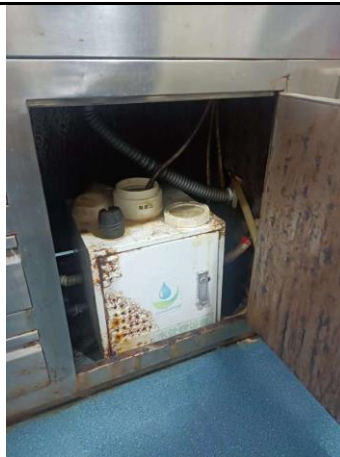
图 2-4 现有项目污水处理设施照片
