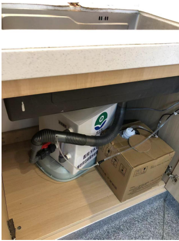
图 2-5 污水处理设施照片
