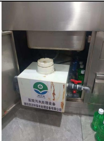
图 2-4 污水处理设施照片
