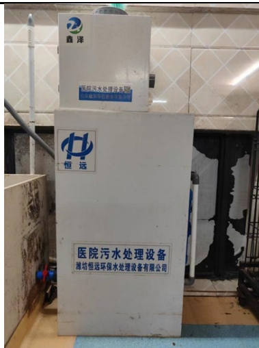
污水消毒处理设施照片
