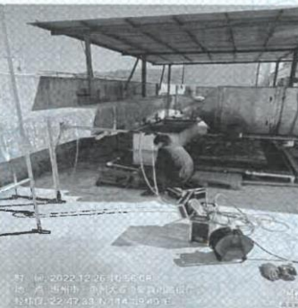
图 16: DA009 废气进气口 2# (2022.12.26)
