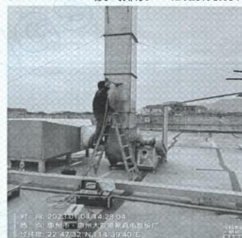
图 26: DA003 废气排放口 (2023.01.03)
