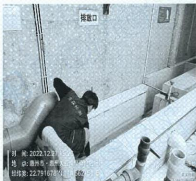
图 15: 生产废水排放口 第三次 (2022.12.27)
