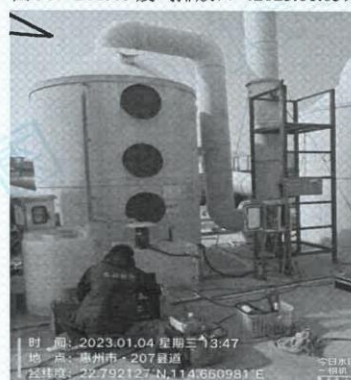
图 40: DA012 废气排放口 (2023.01.04)
