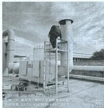
图 43: DA018 废气排放口 (2023.01.07)
