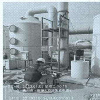
图 30: DA012 废气排放口 (2023.01.03)
