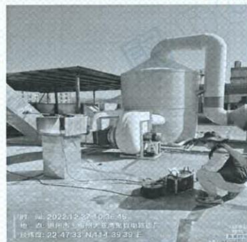
图 18: DA009 废气进气口 1# (2022.12.27)
