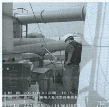
图 29: DA012 废气进气口 (2023.01.03)
