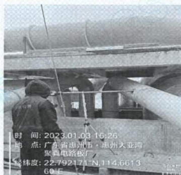
图 23: DA020 废气进气口 (2023.01.03)
