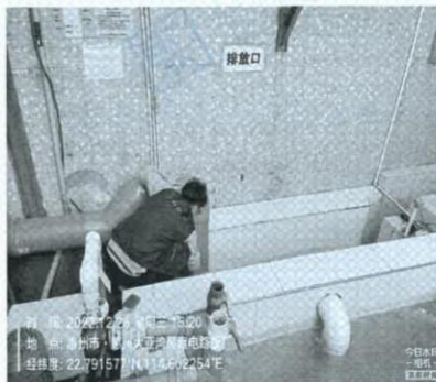
图 19: 生产废水排放口 第三次 (2022.12.28)
