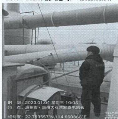
图 37: DA005 废气进气口 (2023.01.03)
