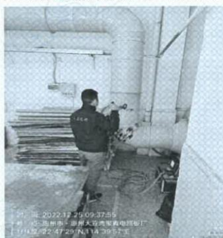
图 8: DA006 废气进气口 (2022.12.25)
