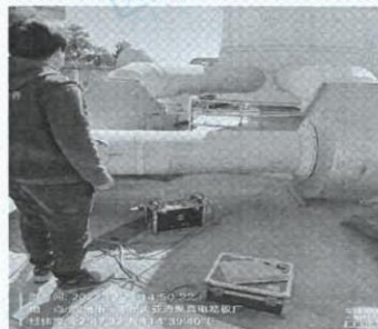
图 3: DA021 废气进气口 1# (2022.12.24)
