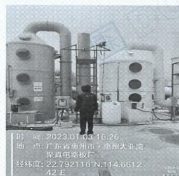
图 24: DA020 废气排放口 (2023.01.03)
