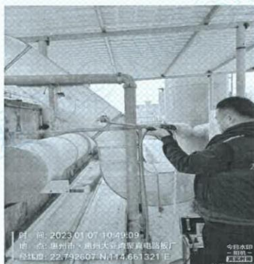
图 41: DA018 废气进气口 1# (2023.01.07)
