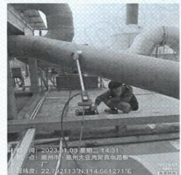
图 27: DA005 废气进气口 (2023.01.03)
