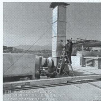
图 36: DA003 废气排放口 (2023.01.04)
