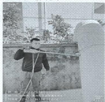
图 13: DA021 废气进气口 4# (2022.12.25)
