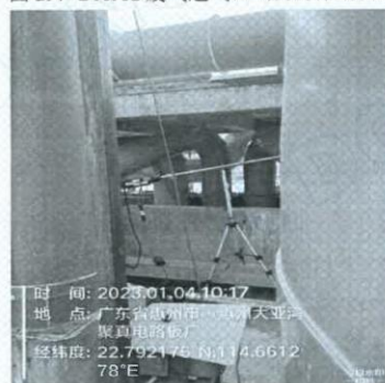
图 31: DA017 废气进气口 (2023.01.04)
