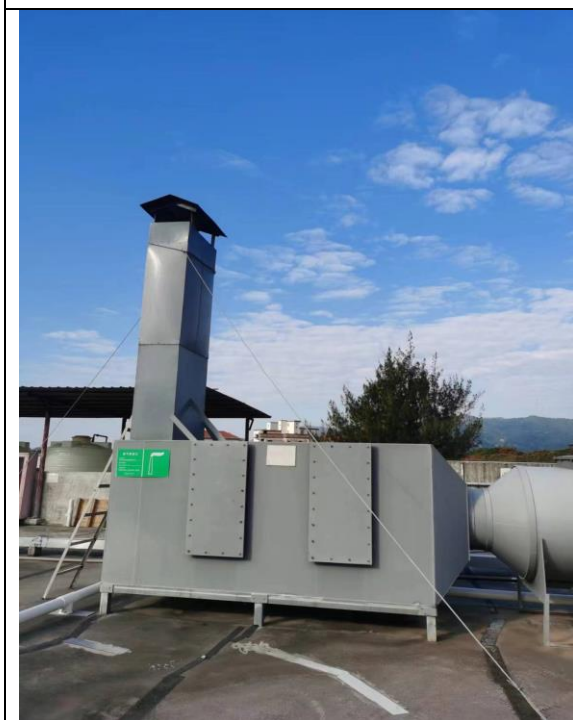
喷锡废气排放口与标识牌 FQ-34301-13
