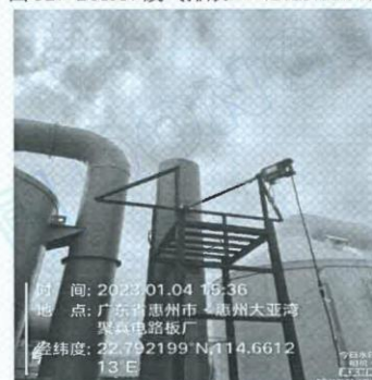
图 34: DA020 废气排放口 (2023.01.04)
