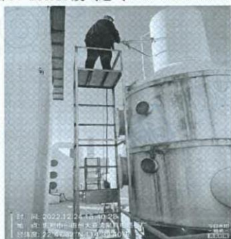
图 7: DA021 废气排放口 (2022.12.24)
