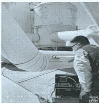
图 5: DA021 废气进气口 3# (2022.12.24)
