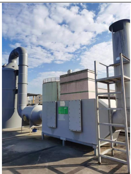
喷锡废气排放口与标识牌 FQ-34301-5
