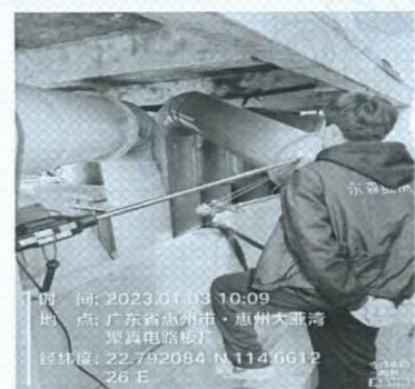
图 21: DA017 废气进气口 (2023.01.03)
