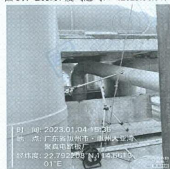
图 33: DA020 废气进气口 (2023.01.04)
