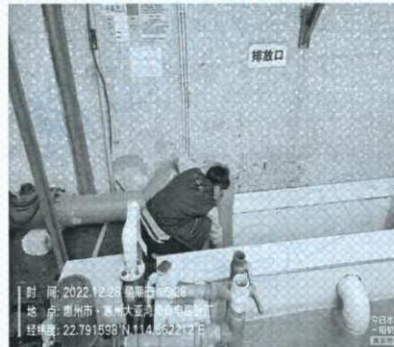
图 20: 生产废水排放口 第四次 (2022.12.28)
