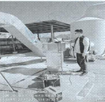
图 15: DA009 废气进气口 1# (2022.12.26)
