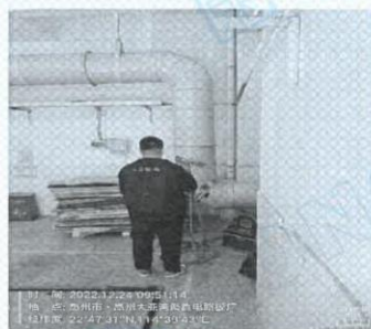
图 1: DA006 废气进气口 (2022.12.24)
