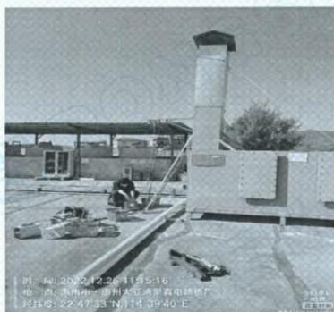
图 17: DA009 废气排放口 (2022.12.26)
