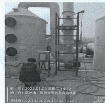
图 28: DA005 废气排放口 (2023.01.03)
