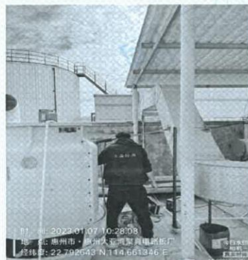
图 42: DA018 废气进气口 2# (2023.01.07)
